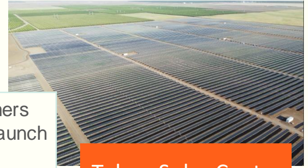
Tulare Solar Center
